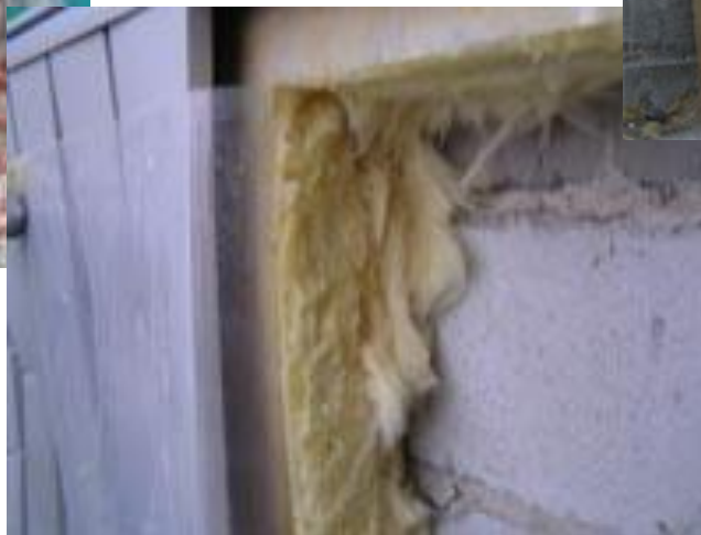
Рис.2. Утеплитель примененный в жилом доме по адресу Б-Марлинского 1/2.
