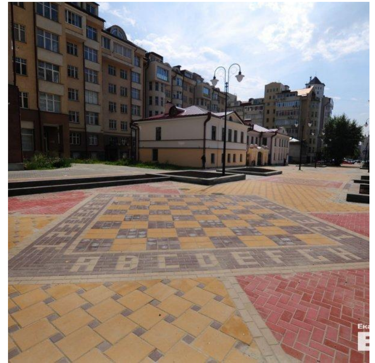
Реконструкция Красноармейской улицы на участке от ул. Карла Маркса до ул. Энгельса Проектные и строительные работы - «Атомстройкомплекс» Екатеринбург, Россия 2015
