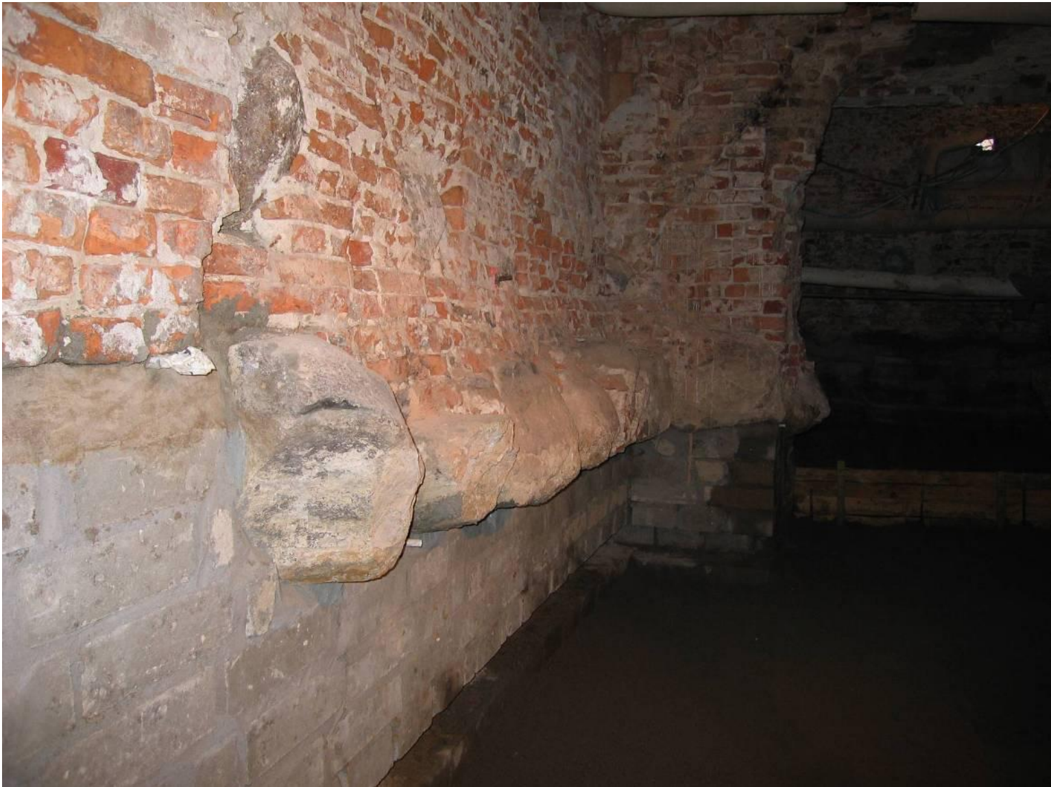
Rys. 4 Wyoblone gazy wbudowane w przekrój fundamentu w Archikatedrze Wojska Polskiego.
