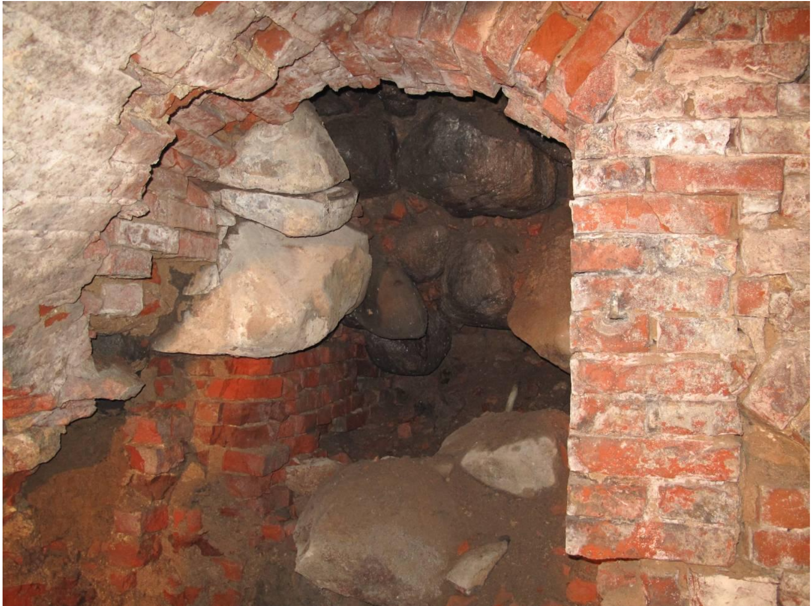
Rys. 2. Przykład rozpadu muru fundamentowego zamku krzyżackiego w Jegławkach.
