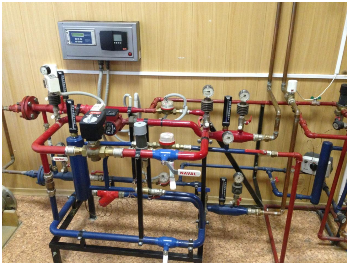
СТЕНД ТЕПЛОВОГО ПУНКТА.
