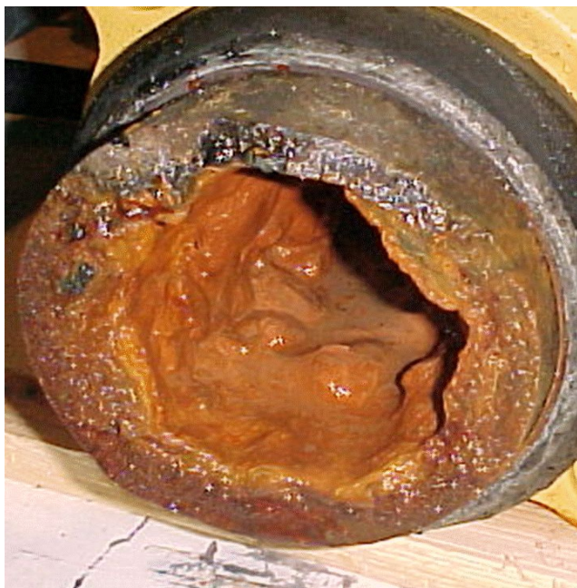
Биопленка на внутренней поверхности водопроводной трубы
