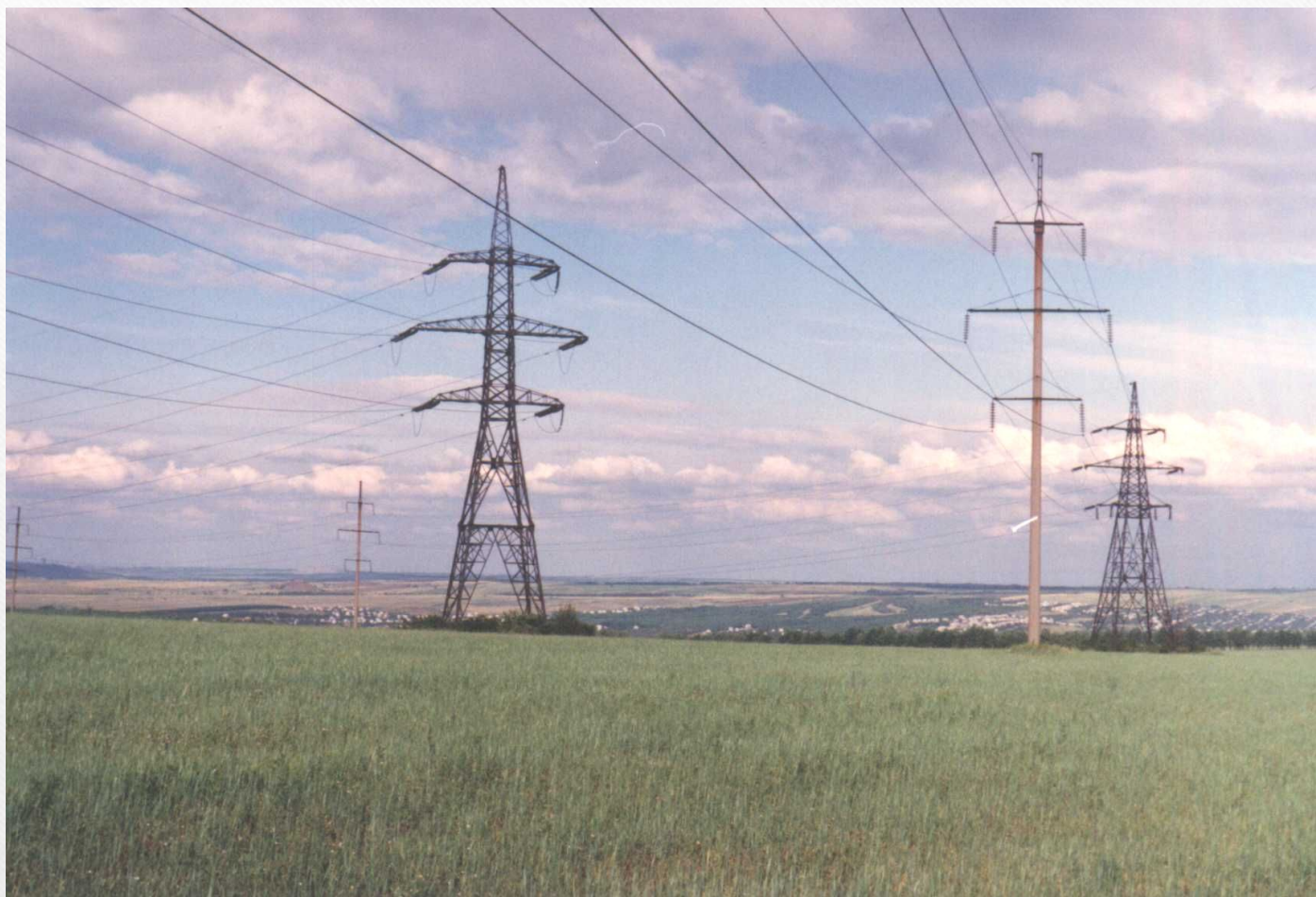
Двухцепные анкерно-угловая металлическая опора ВЛ 220кВ (слева) и промежуточная железобетонная опора ВЛ 110 кВ (справа)
