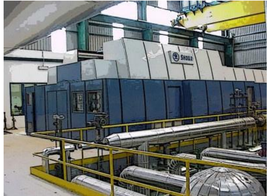
Паротурбинная установка MTD 40 skoda
