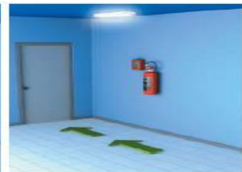
Возле каждой пожарной кнопки и огнетушителя.....
