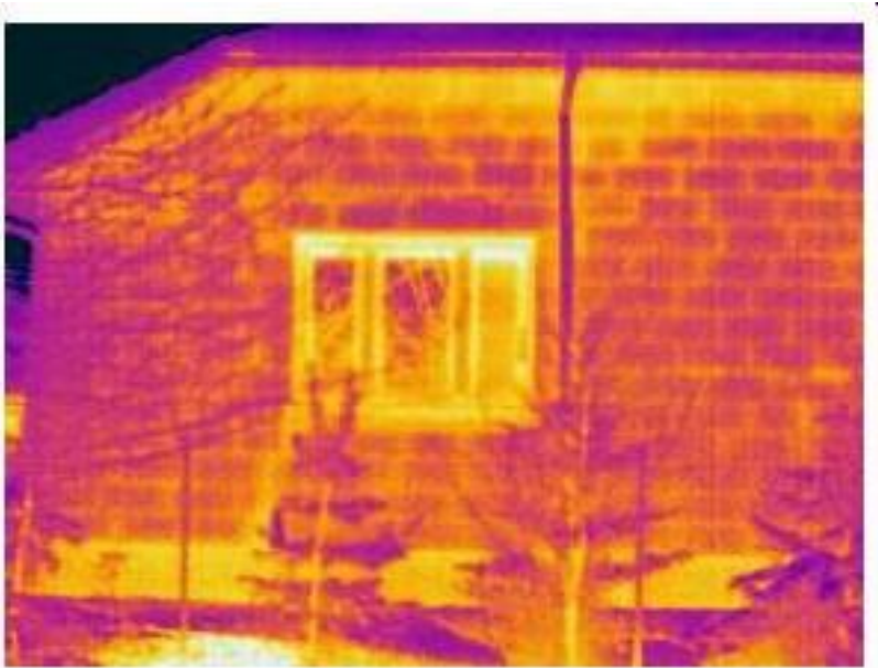
Рис. 1. Потери тепла через кладочные швы, выполненные на традиционном растворе
