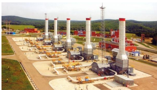
ГТУ-12П в составе ГПА-12/16 на КС «Краснодарская», ООО «Газпром трансгаз Кубань»
