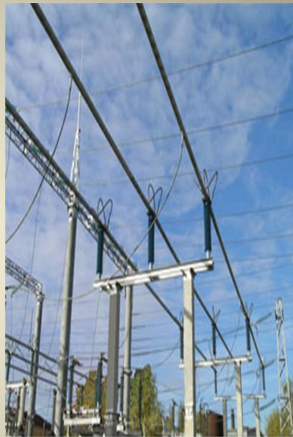
Рисунок 1. Жесткая ошиновка ОРУ 110 кВ ПС «Кировская» ОАО «Тулэнерго»
