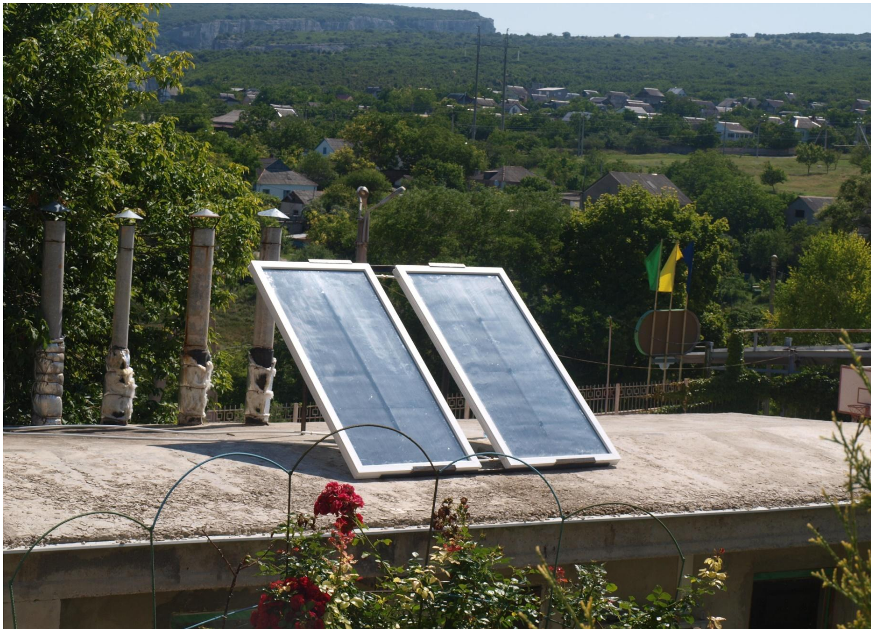
СОЛНЕЧНАЯ УСТАНОВКА НА БАЗЕ ОТДЫХА «ПЯИБАЛ», Г. БАХЧИСАРАЙ. ПРОИЗВОДИТЕЛЬНОСТЬ 300-400 Л ГОРЯЧЕЙ ВОДЫ В ДЕНЬ
