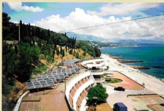
Солнечная котельная, Алушта, санаторий «Рабочий уголок», 200м 2 . Работает с 2002 г., 20 куб.м.горячей воды в день.
