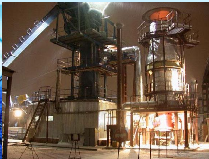
Установка по газификации твердого топлива производства ФГУП «НПЦ газотубостроения «Салют»»
