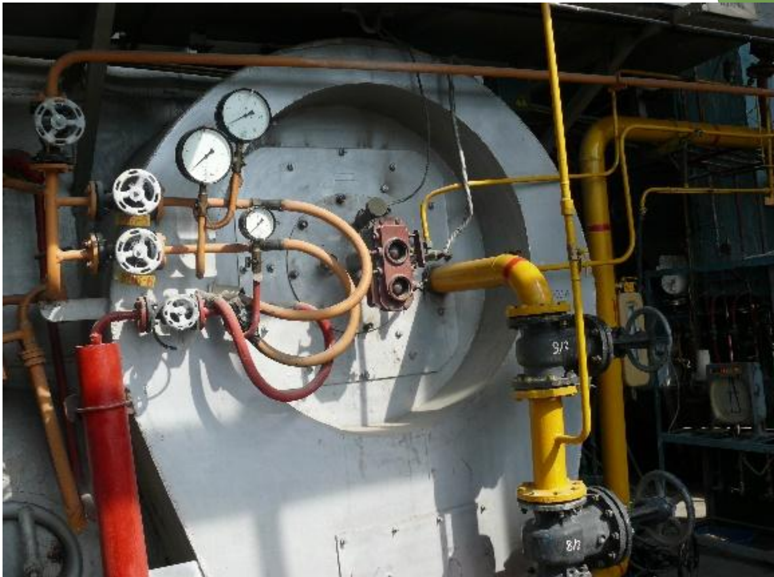
Обвязка газовой горелки
