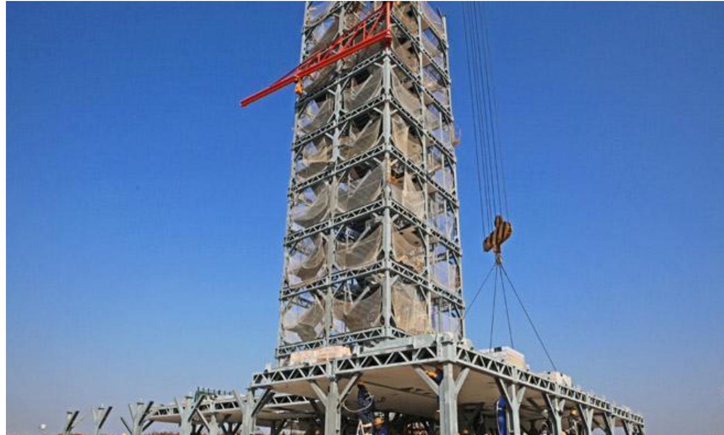
Грузоподъемный механизм –монтажная стрела
