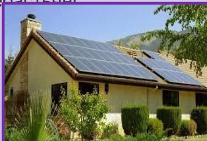
Сонячні батареї на даху будинку
