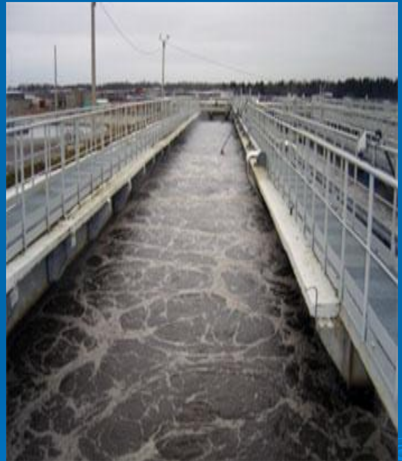
•Аэротенк для очистки сточных вод на Сестрорецких очистных сооружениях
