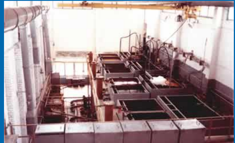
•Станция нейтрализации сточных вод
