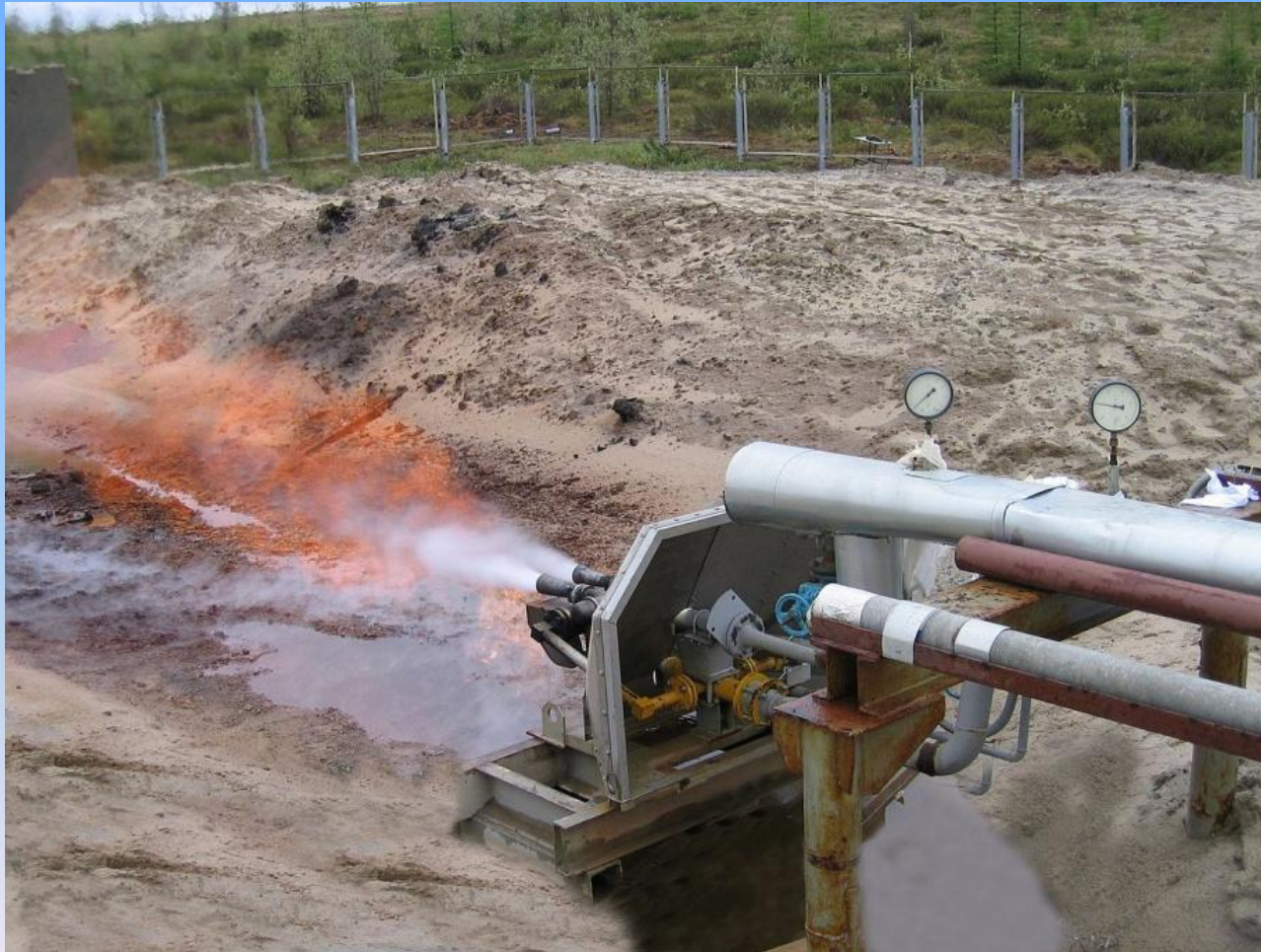
Факельная установка ГФУ-5 сжигает стоки на месторождении Медвежье. 2009
