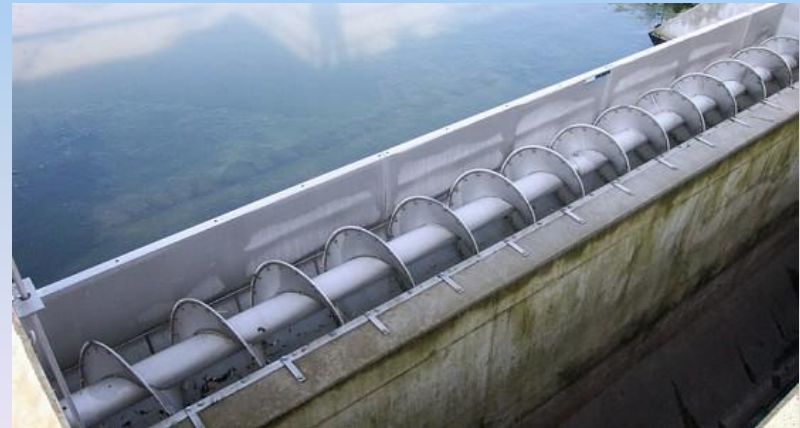
Механическая очистка вод общесплавной канализации и ливневых стоков.
