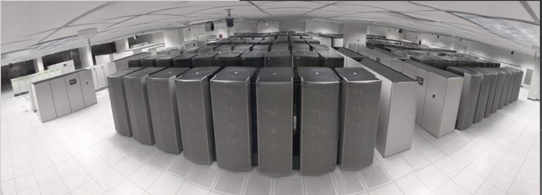
Gesamtansicht des Supercomputers
