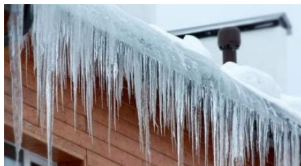
Наледь на крыше (в холодный период отопительного сезона)
