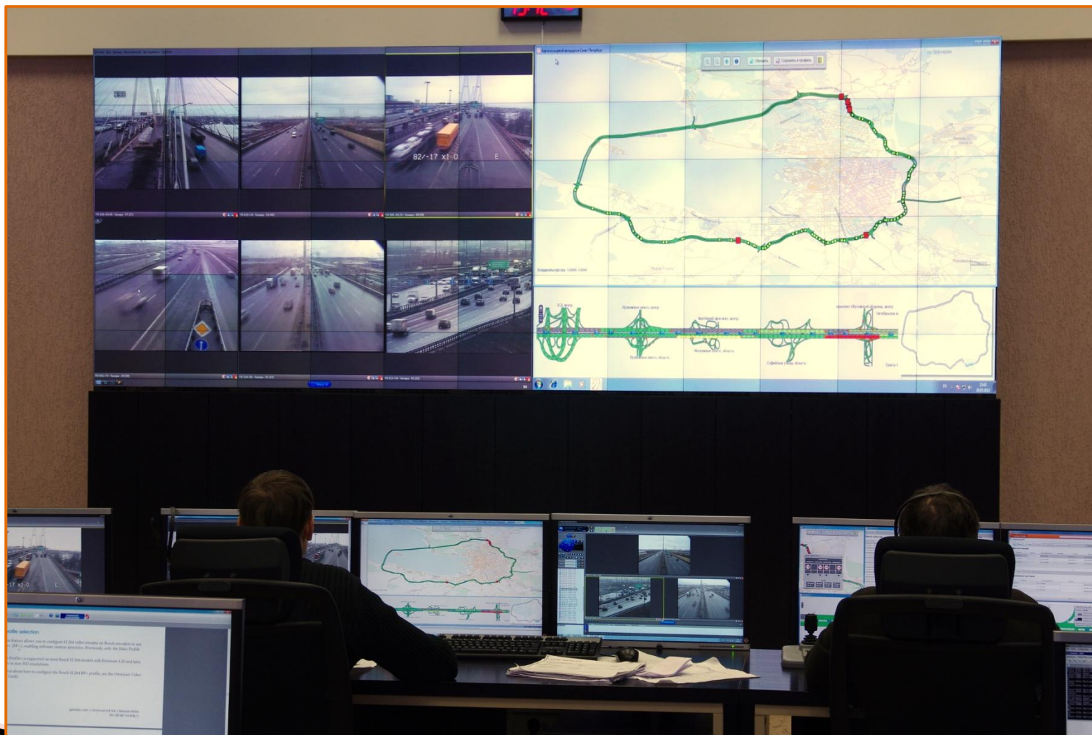
Диспетчерский зал Центрального пункта управления КАД
