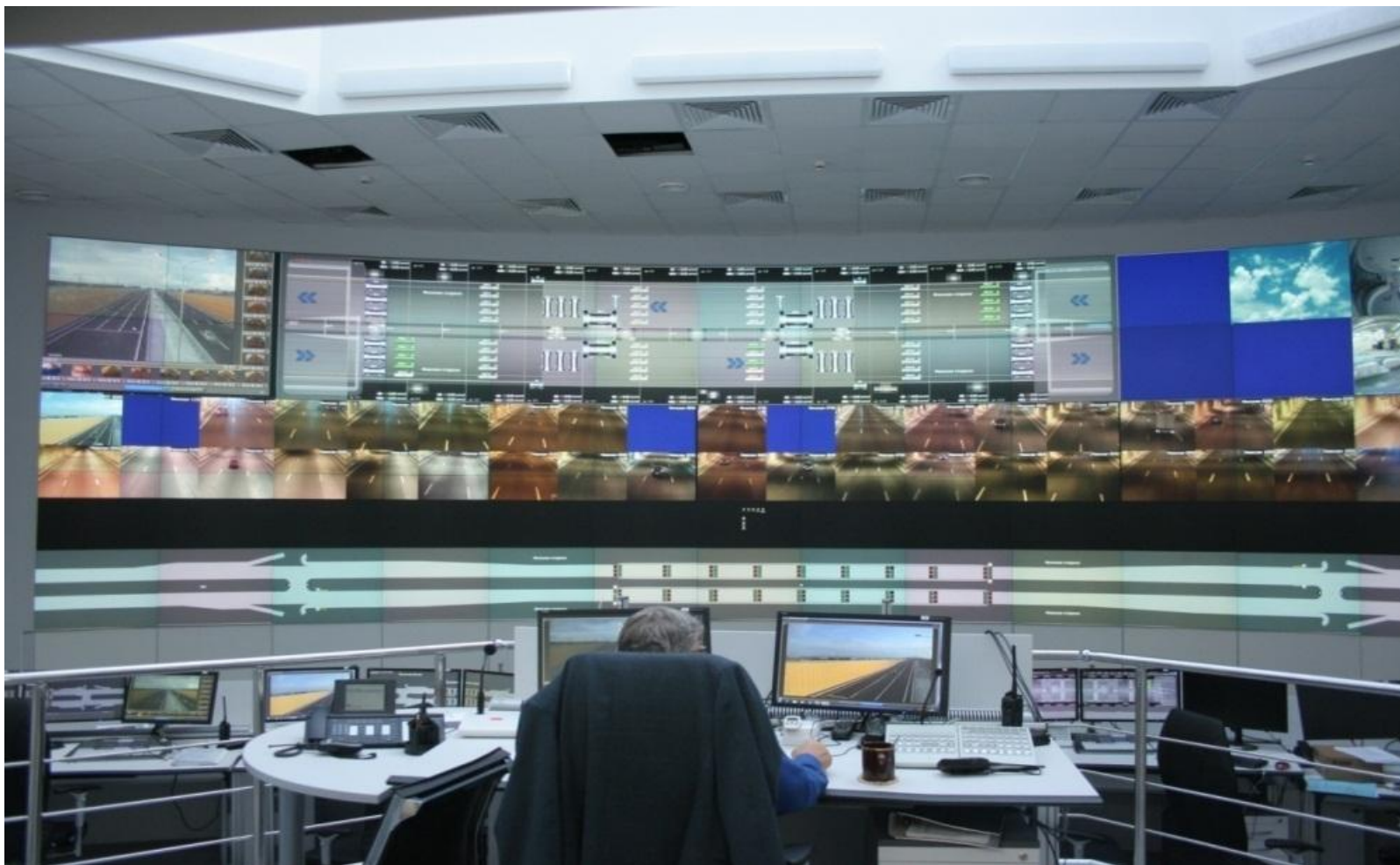
Операционный зал Центрального диспетчерского пункта тоннеля
