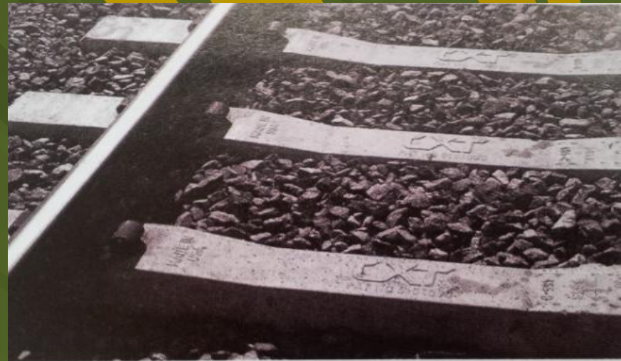
Рис. 1. Путь на железобетонных шпалах компании СХТ
