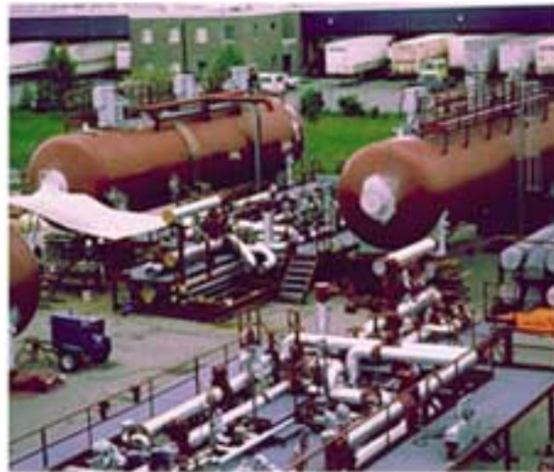
Рис.2. Электрообессоливающая установка фирмы Aker Kvaerner
