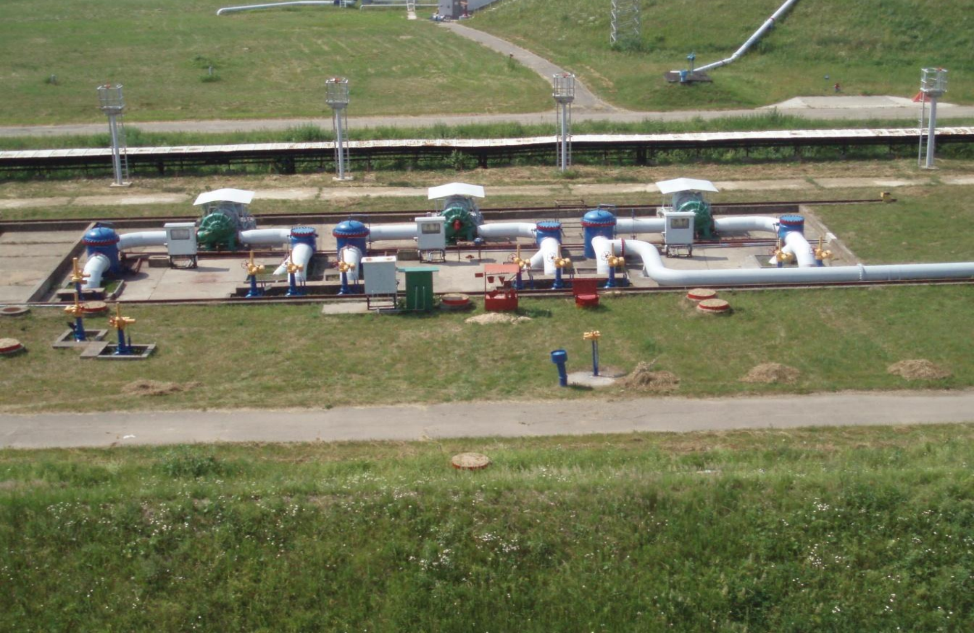
Рис. 2.8 Открытая насосная (электродвигатели находятся под навесами)
