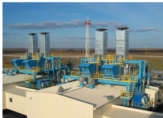
ОАО «НПО «Сатурн» ГТЭС-2,5 на ГКМ Песцовое для ООО «Газпром добыча Уренгой», (2006г.)
