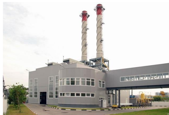
ОАО «НПО «Сатурн» ГТА-6PM в составе ГТУ-ТЭЦ в г. Москва (РТС «Курьянова») для Московского агентства по энергосбережению (2005г.)
