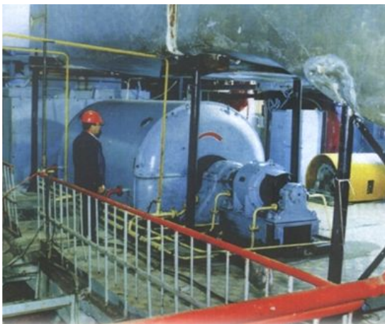
ЗАО «Уфа-Авиагаз», ОАО «УМПО», МПП «Мотор» ГТП-10/953 в Котельном цехе №5 г. Ишимбай, для ОАО «Башкирэнерго», (2002г.)
