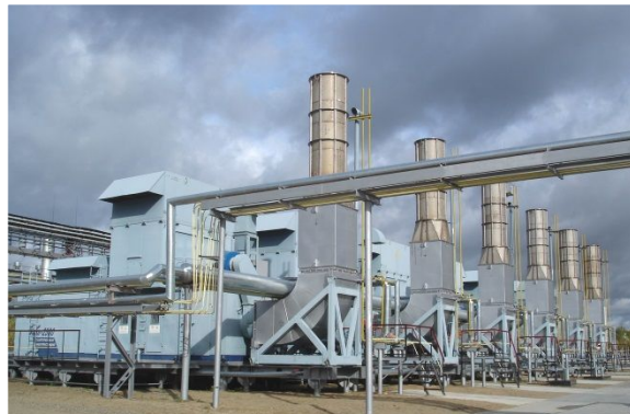
ОАО «Пермские моторы» ГТЭС «Урал-2500», Сосьвинское ЛПУ для ООО «Газпром трансгаз Югорск» (2005 г.)
