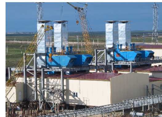
ОАО «НПО «Сатурн» ГТЭС-2,5 на ГКМ Харвутинское ООО «Газпром добыча Ямбург», (2007г.)
