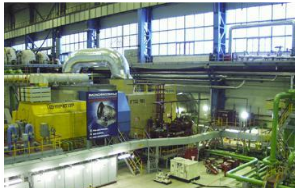
ОАО «НПО «Сатурн» ГТЭ-110 № 2, г. Комсомольск, Ивановская область ОАО «Испытательный стенд» для ОАО «РАО «ЕЭС России» (2001г.)
