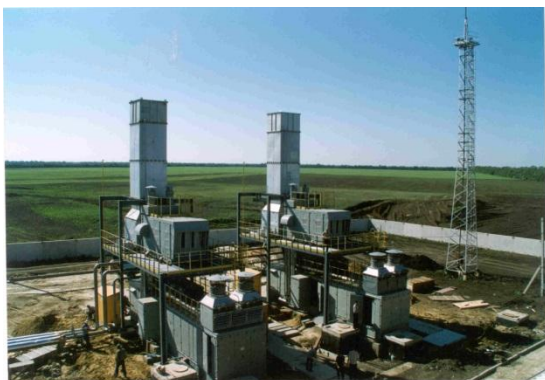
ОАО «НПО «Сатурн» ГТЭС-2,5 на КС Сальская для ООО «Газпром трансгаз Ставрополь», (2003г.)
