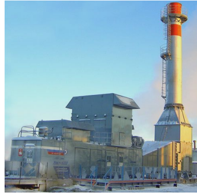
ОАО «Пермские моторы» ГТЭС «Урал-6000» в составе ГТУ-ТЭЦ на Северо-Губкинском МНГ для ООО «Лукойл – Западная Сибирь» (2006 г.)
