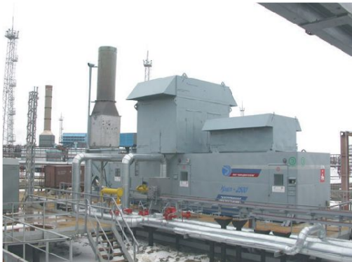
ОАО «Пермские моторы» ГТЭС «Урал-2500», ДКС Юбилейная, ООО «Газпром добыча Надым» (2004г.)
