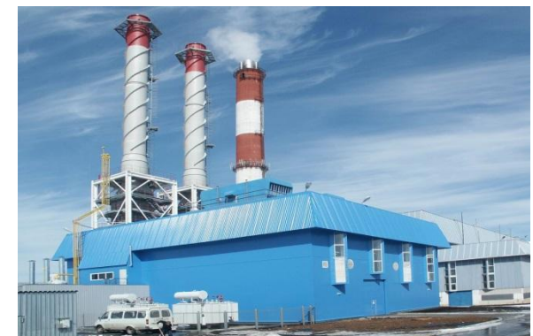
ОАО «НПО «Сатурн» ГТА-6PM в составе ГТУ-ТЭЦ в г. Москва (РТС «Пенягино») для Московского агентства по энергосбережению (2006г.)
