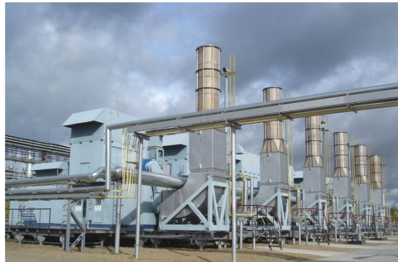
ОАО «Пермские моторы» ГТЭС «Урал-2500», Сосьвинское ЛПУ для ООО «Газпром трансгаз Югорск» (2005 г.)
