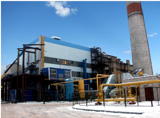
ОАО «Пермские моторы» ГТЭС «Урал-6000» в составе ГТУ-ТЭЦ в г. Иваново для ОАО «ТГК-6» Ивановский филиал (2004 г.)
