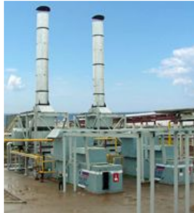
ОАО «Пермские моторы» ГТЭС «Урал-4000» в составе ГТУ-ТЭЦ «Агидель» для ООО «Башкирская генерирующая компания» (1997 г.)
