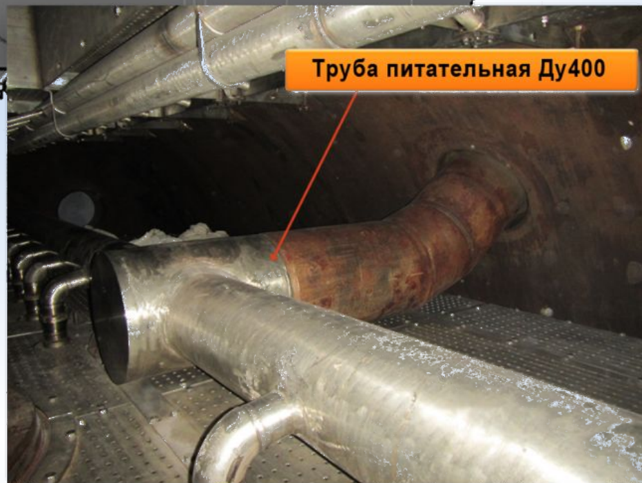
патрубок для подачи питательной воды
