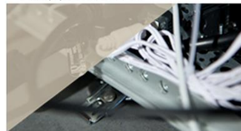
Залы с компьютерным оборудованием
