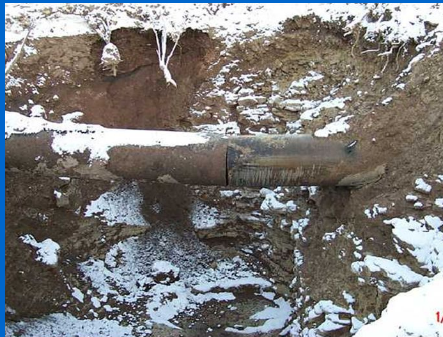
Авария МГ Ямбург-Елец в Кишертском районе
