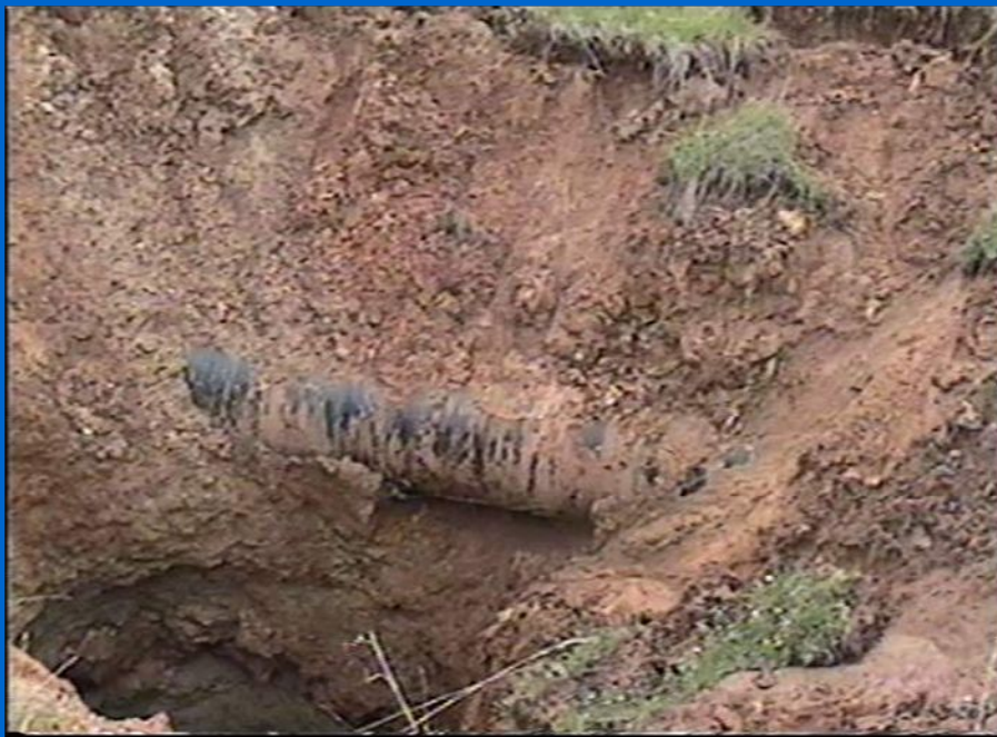
Карстовый провал на МГ Ямбург-Тула1 1629км районе в Добрянском
