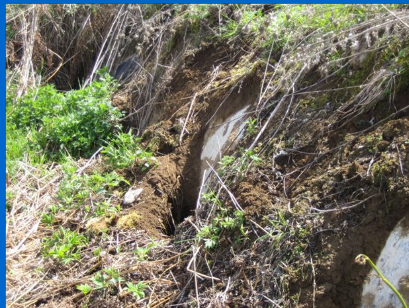
Обнажение трубы в карстовом провале МГ Центр 1 на 1648 км (Опачевский полигон)
