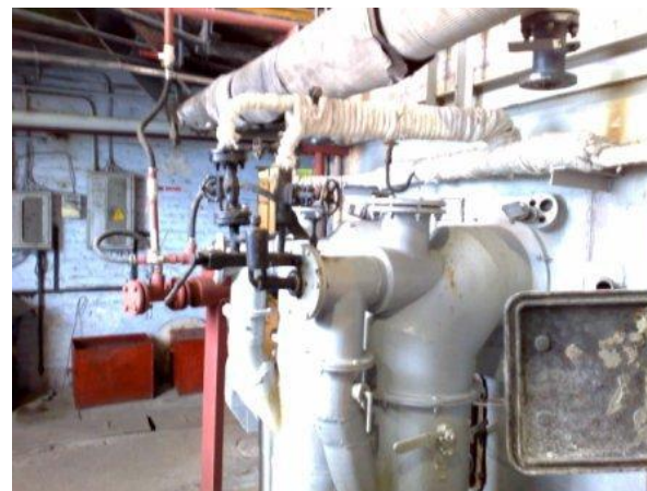
Котёл ДКВР-6,5, с горелками для ВУТ
