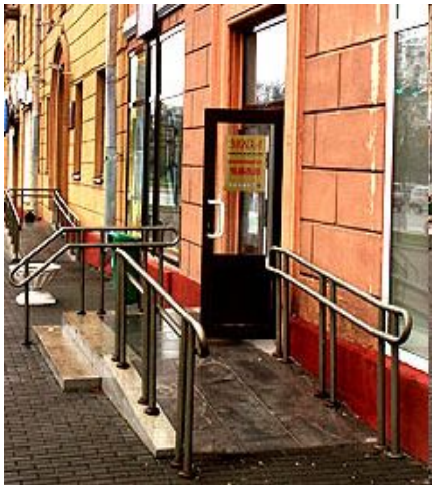
Входная дверь не должна открываться на пандус
