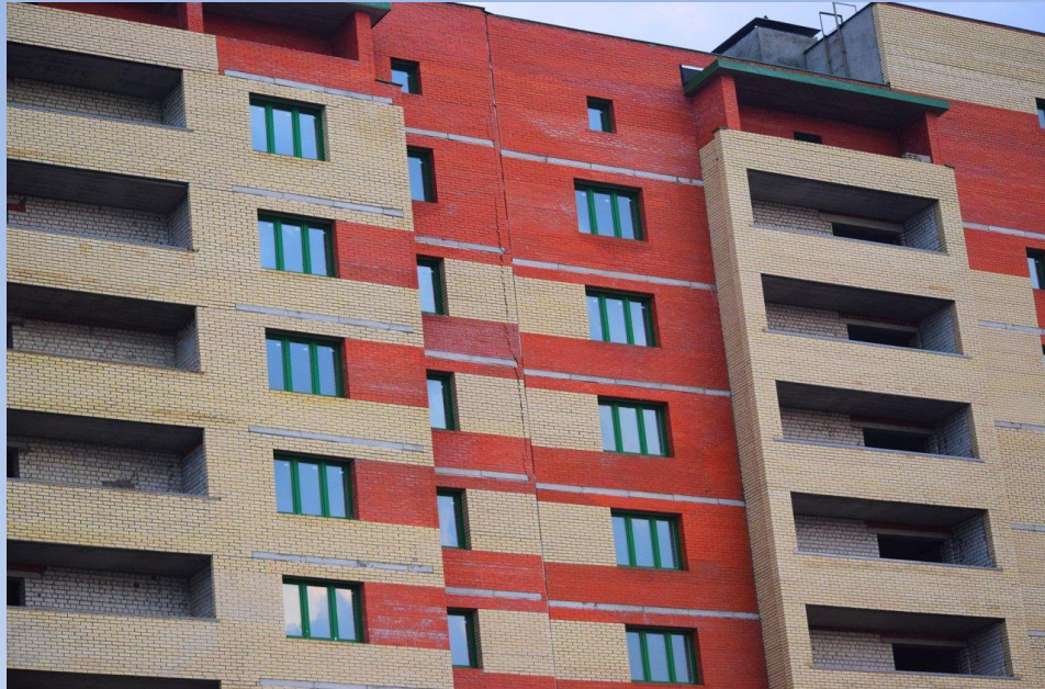
Трещина в облицовке, в связи с осадкой секции здания.
