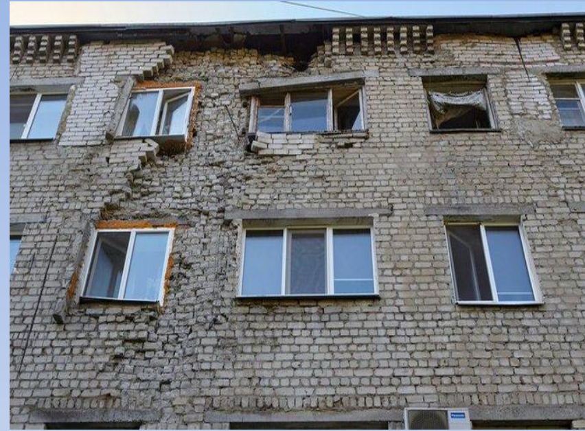
Частичное обрушение кладки здания в результате деформации грунтового массива
