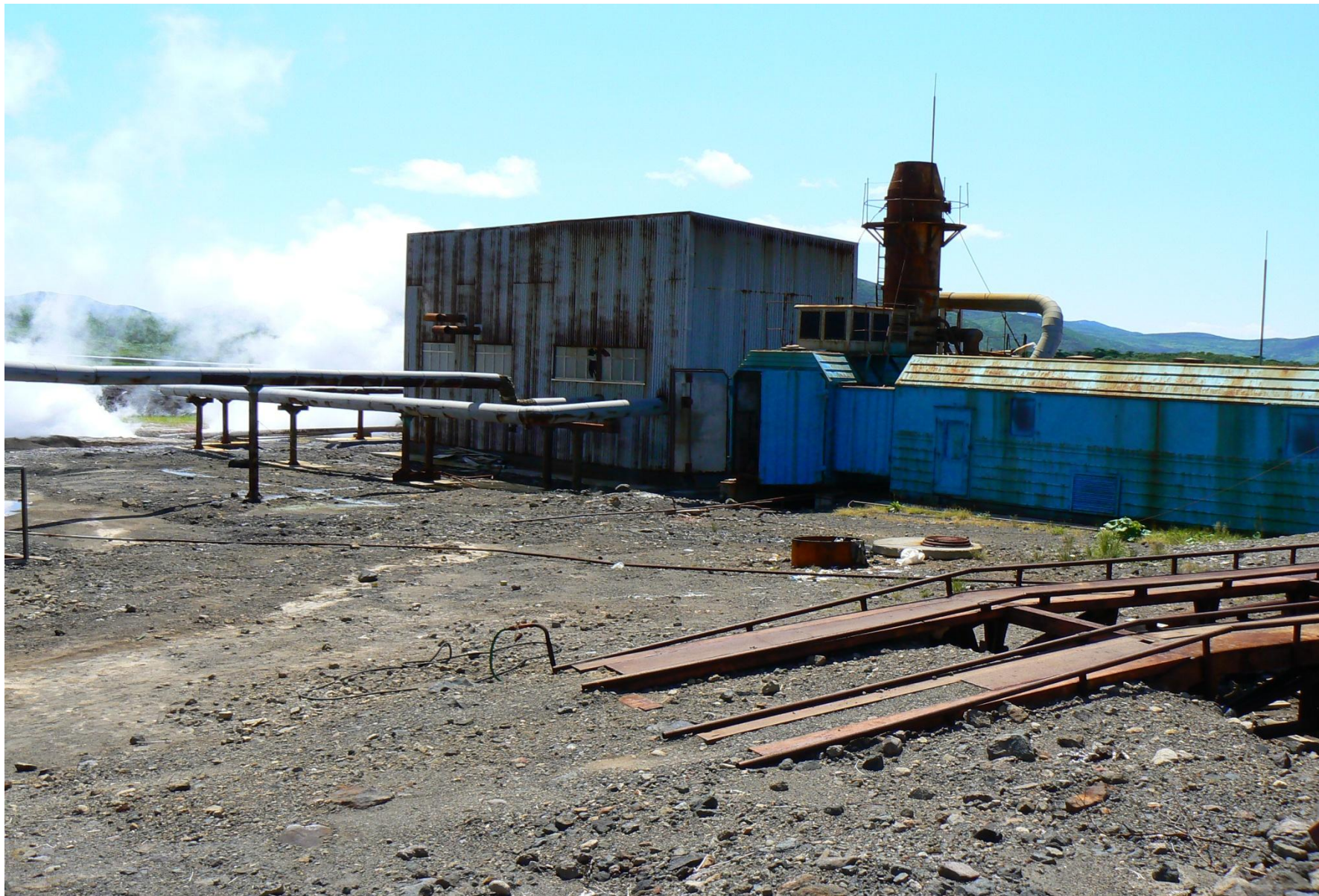
Геотермальная электростанция (Россия, о.Итуруп, 2010 г)
