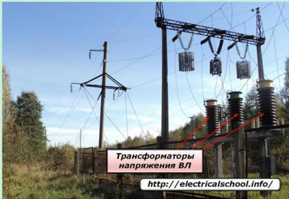
Ввод ВЛ-110 кВ на подстанцию 110/10кВ
