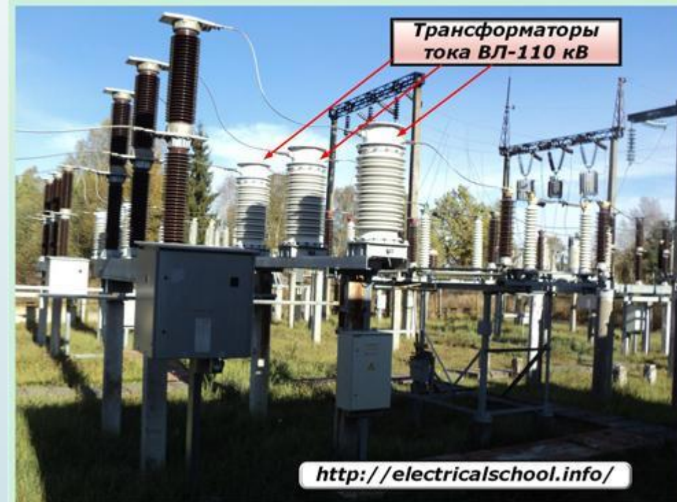
Трансформаторы тока ВЛ-110 кВ на подстанции 110/10кВ
