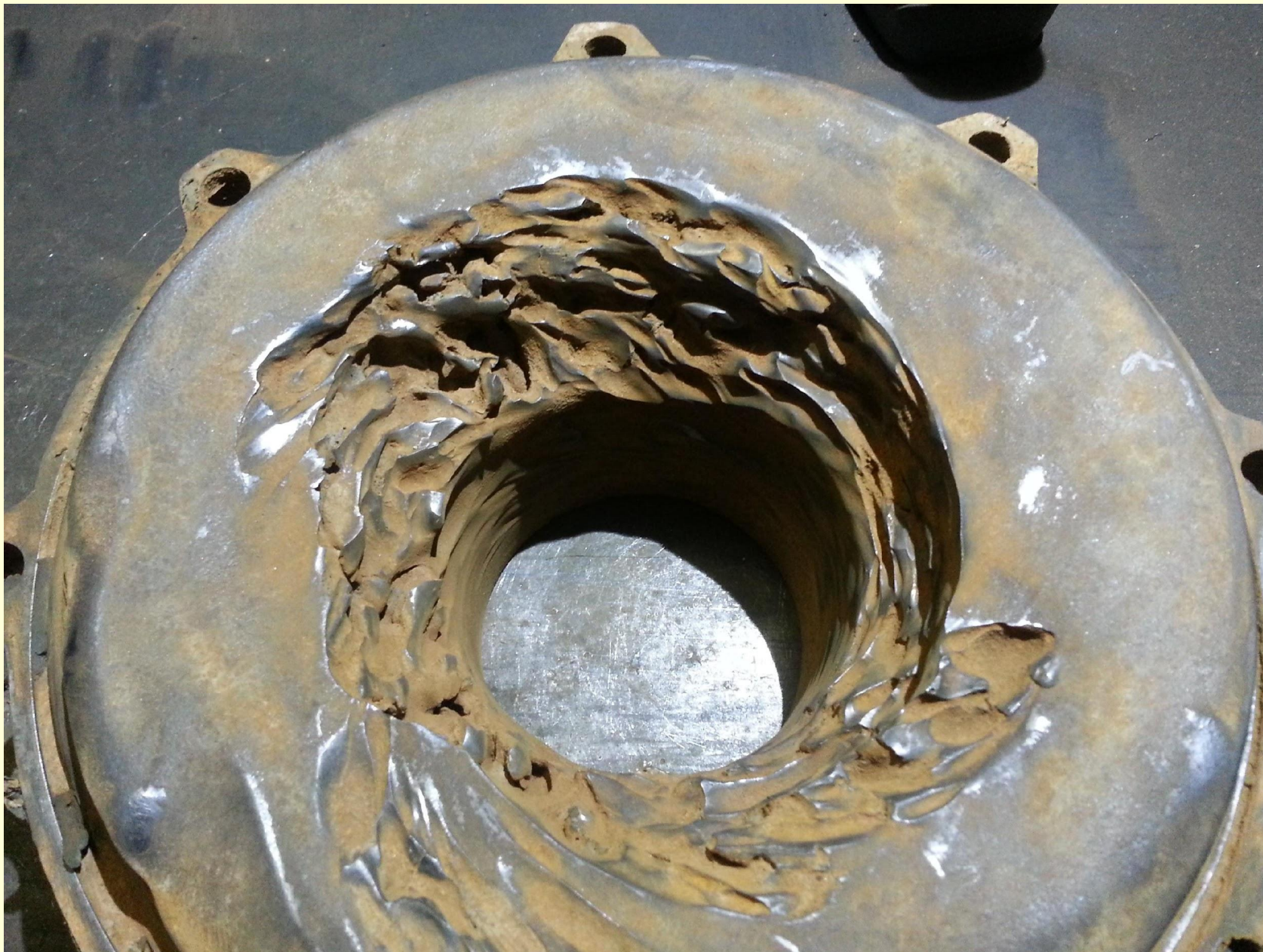
Последствия эрозионно-кавитационного разрушения патрубка насоса
