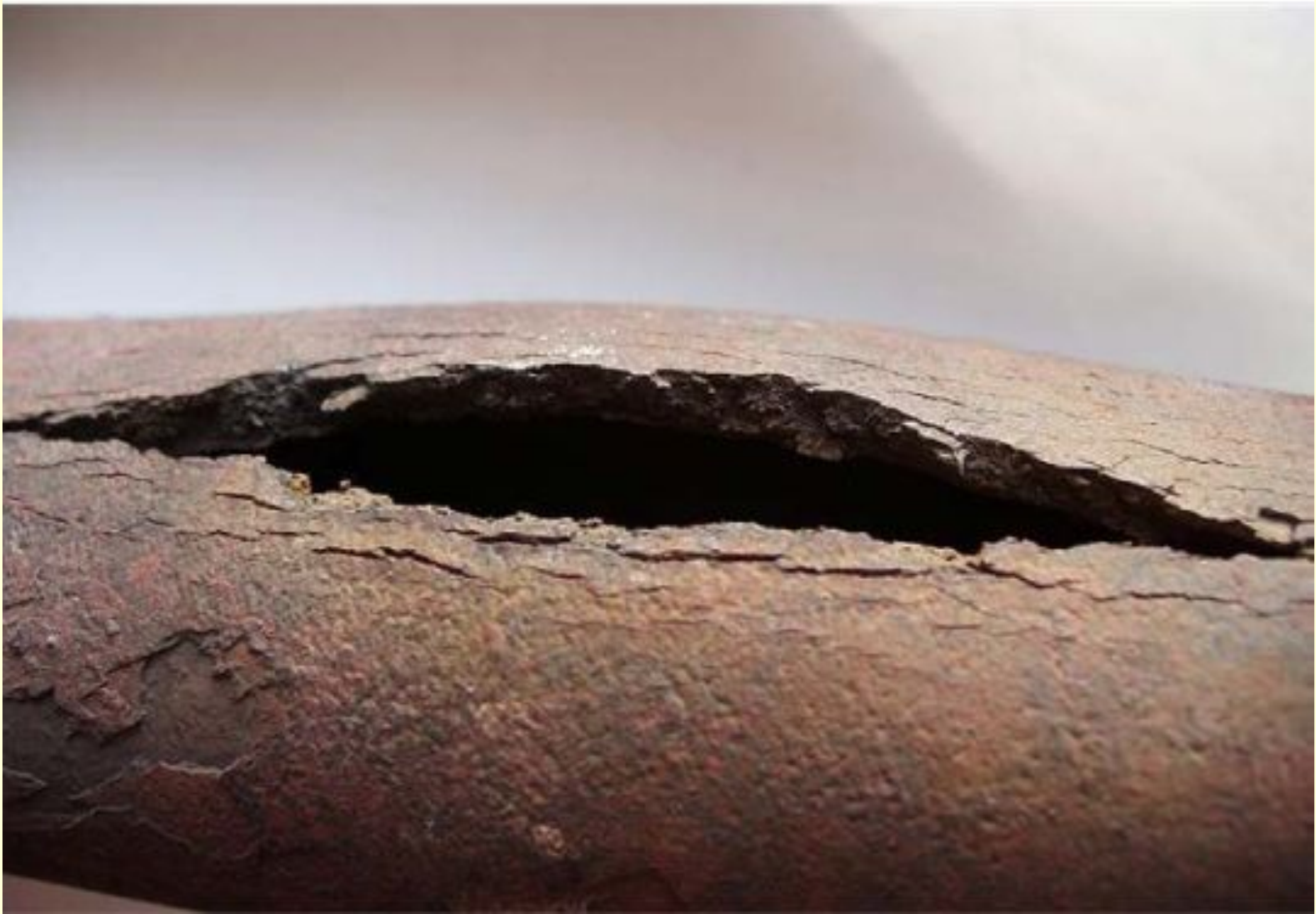
Продольный разрыв трубы пароперегревателя
