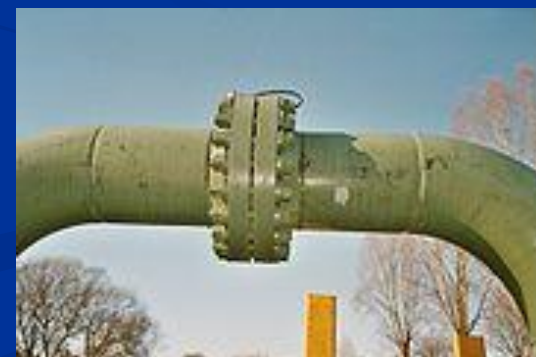
Фланцевое соединение газовых труб
