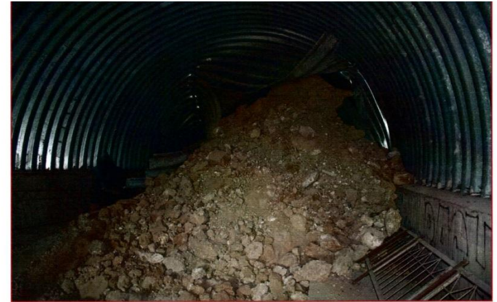
Фото 5. Вывал грунта земляного полотна внутрь арки.
