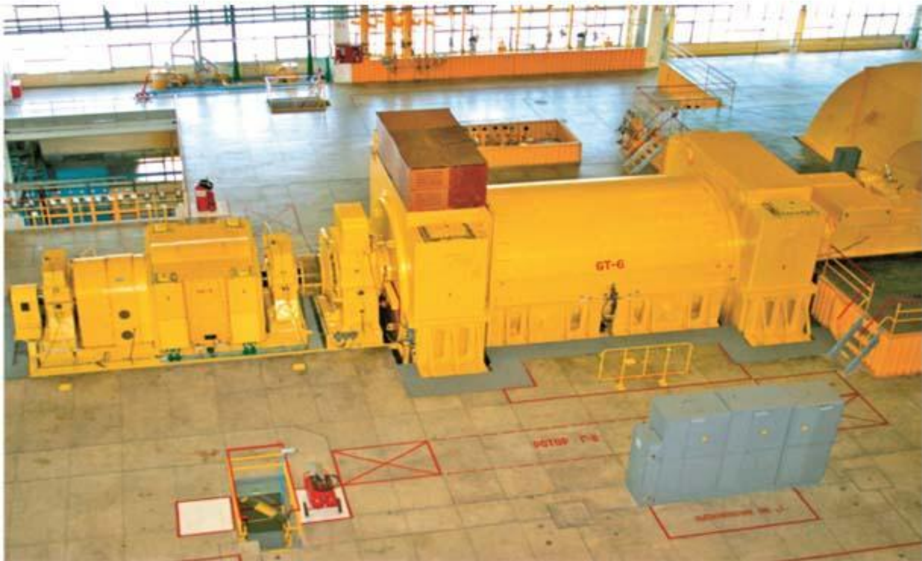
Рис 1.2 Внешний вид турбогенератора ТГ-6 Запорожской АЭС типа ТВВ-1000-4УЗ.
