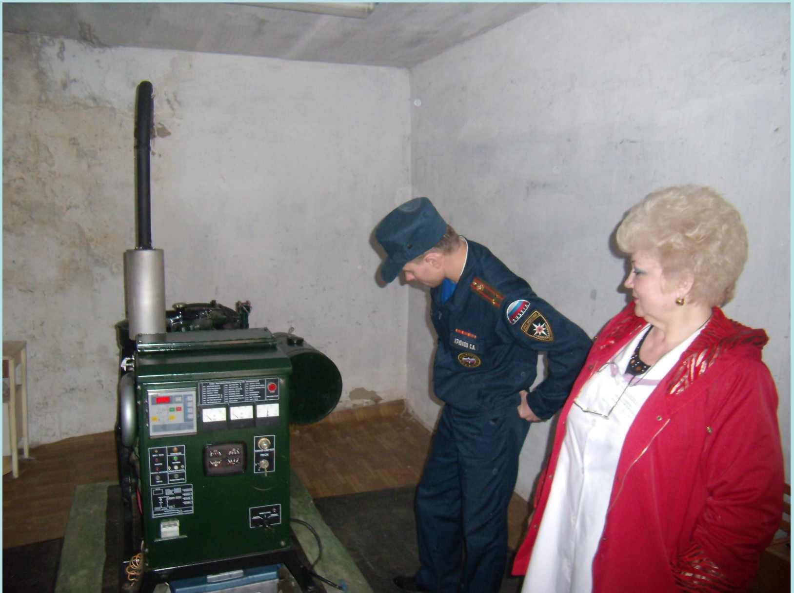
Дизель-электрическая установка (роддом №5 г. Омск)
