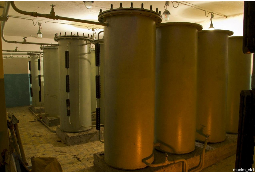
Вертикальный бак аварийного запаса воды
