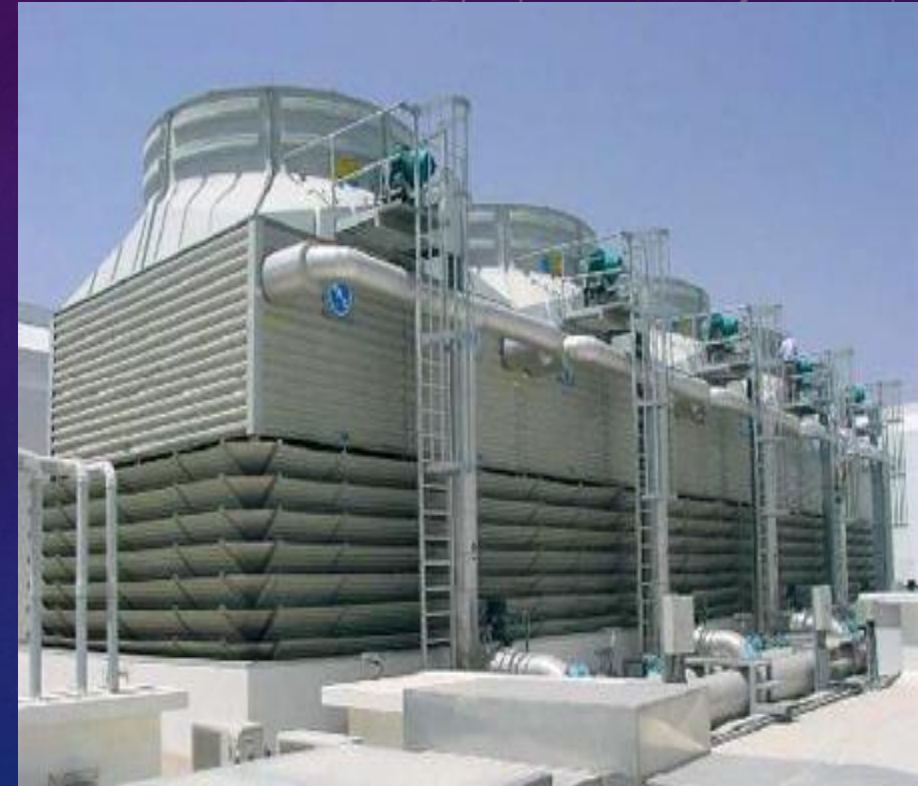
Рисунок. Эжекционные градирни предназначены для охлаждения технической воды до требуемой температуры за счет ее непосредственного контакта с охлаждающим атмосферным воздухом
