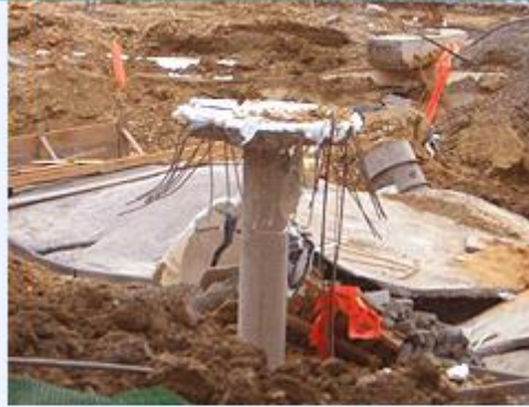
Пример разрушенного перекрытия при продавливании
