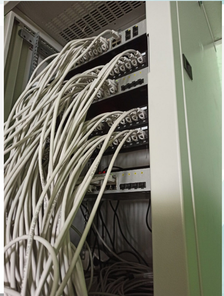
Один из коммутационных шкафов
