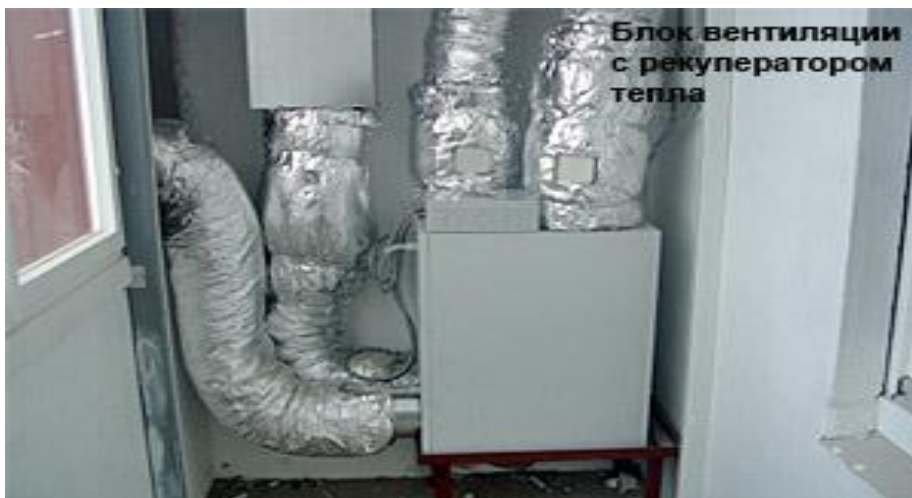
Рекуператоры в лоджии
