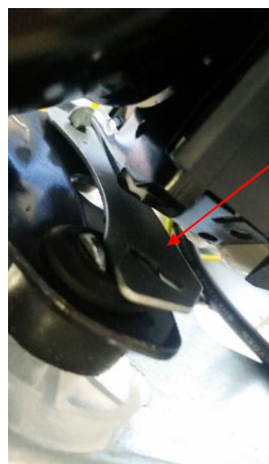
Компрессор не закреплен на подмоторной плите
