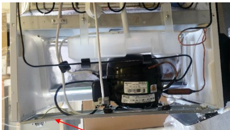
Деформация подмоторной плиты
