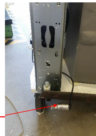
Конденсатор не закреплен
