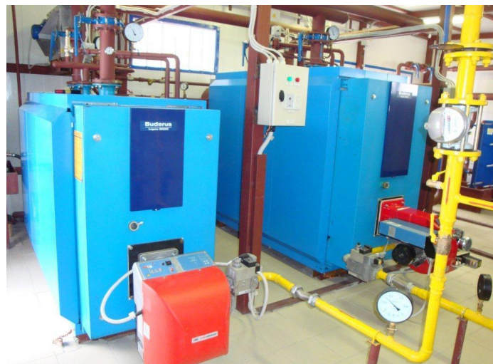
После модернизации котельной
