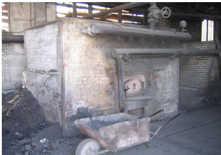
До модернизации котельной (угольной)
