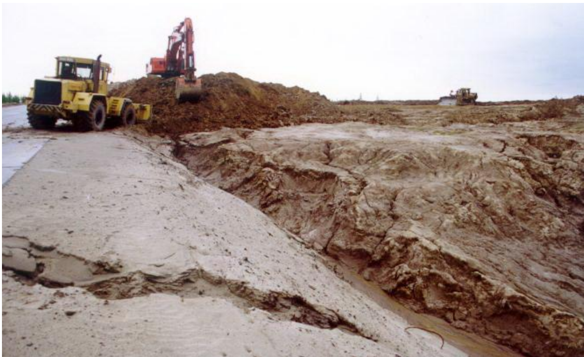
Ремонт земляного полотна (засыпка образовавшейся в следствие эрозии канавы) на промышленной дороге в районе газового месторождения «Заполярье»
