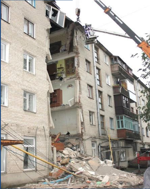
Последствия незаконной перепланировки
