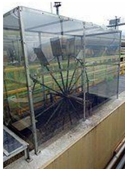
Поверхностная аэрация сооружения биологической очистки с активным илом (Китай)
