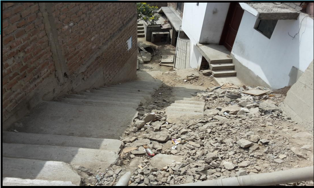
Imagen 27. Escaleras dañada por el empalme clandestino de agua y desagüe, lo cual es un peligro para las personas que transitan usando ese medio.
