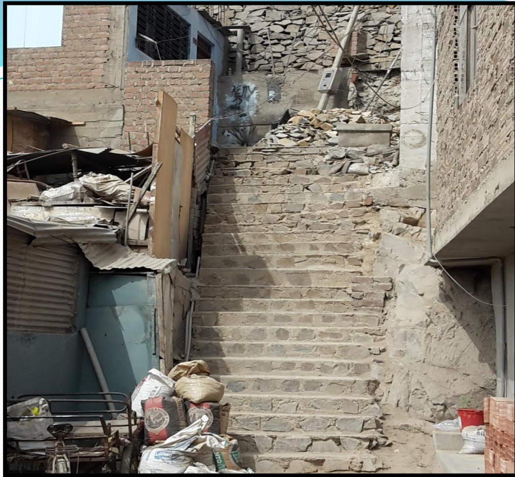
Imagen 23. Escaleras muy empinadas con imperfecciones y desniveles sin ninguna medida de seguridad como barandas, expuesta al desprendimiento de rocas de la parte superior.
