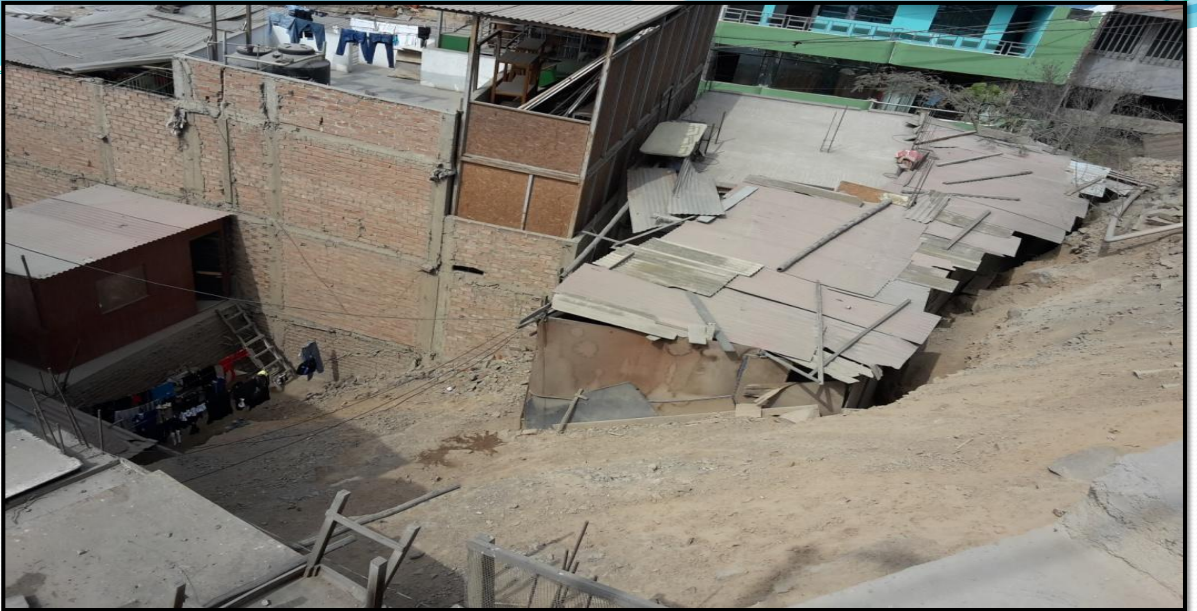
Peligro Físico, vivienda expuesta a deslizamientos y desprendimiento y caída de rocas.
