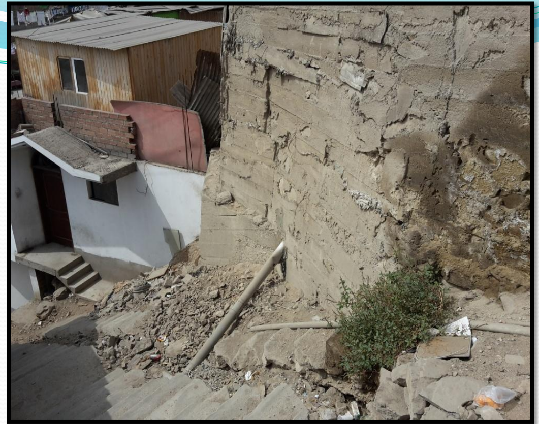
Imagen 26. Escaleras en mal estado y dañadas por el empalme clandestino de agua y desagüe, los cual es un peligro para las personas que transitan usando ese medio. También se puede observar la pared humedecida y probablemente debilitada por escape de agua de estos empalmes de agua.
