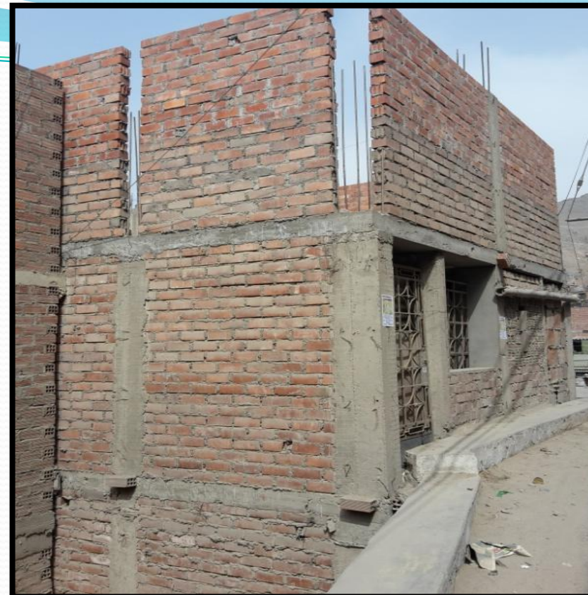
Imagen 32. Informalidad en la construcción y falta de medidas de seguridad, esto queda evidenciado en la pared, ya q esta no se encuentra amarrada a la columna. Falta de señalización o alguna medida de control contra posibles accidentes (muro de unos 6 metros de caída)
