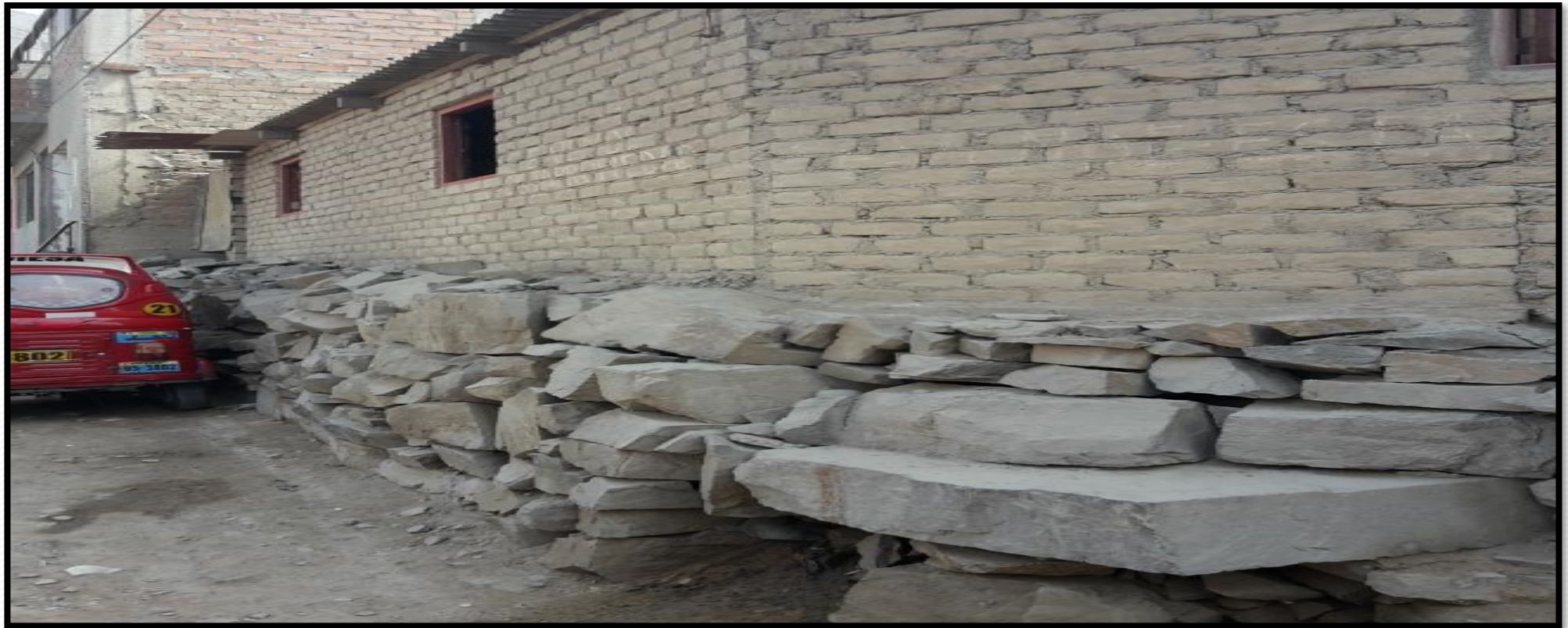
Peligro Físico, construcción informal sin ninguna cimentación.
