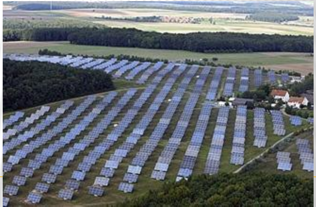
Солнечная электростанция в Германии
